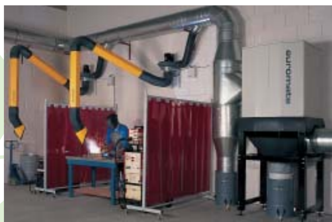
De SCS geïnstalleerd met de vederlicht bedienbare Euromate afzuigarmen
