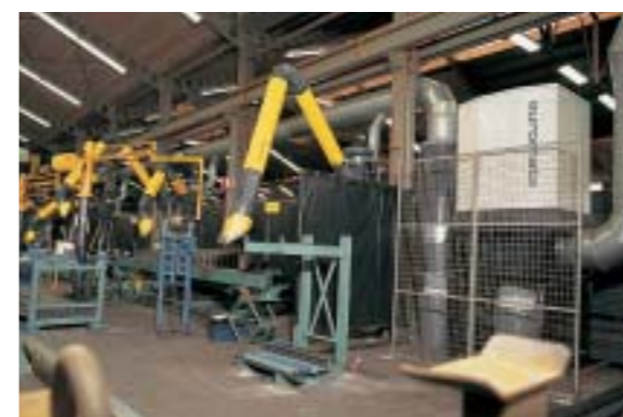
Individuele ventilatoren vanwege flexibiliteit de meest gekozen oplossing (Hovuma, Reuver; Holland)
